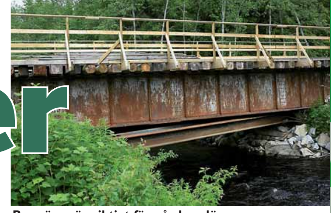
Bra vägar är viktigt för gårdens lönsamhet. Till de bättre investeringarna hör en vägbro, byggd av värdiga järnbalkar som köptes begagnade. Tack vare att balkarna är så långa kunde bron läggas lite snett och rätta ut en besvärande kurva.
